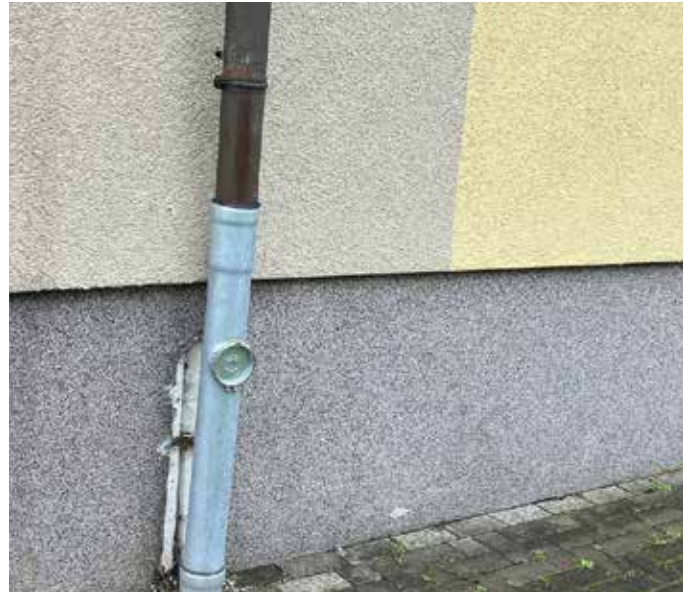
Die gestohlenen Kupferrohre wurden inzwischen durch Kunststoffrohre ersetzt.
